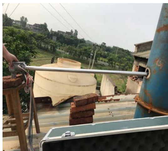
熔炼烟尘排气筒出口
