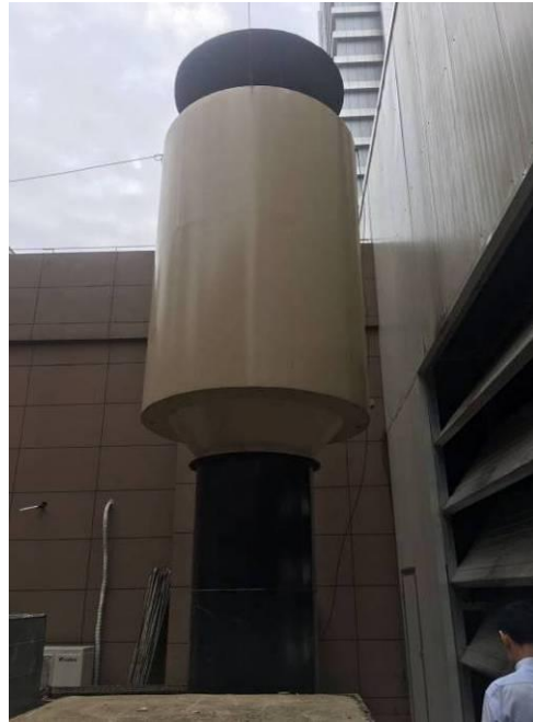
锅炉废气排口
