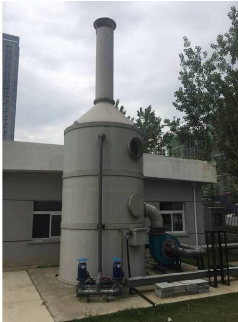
污水处理站恶臭气体处理装置排口
