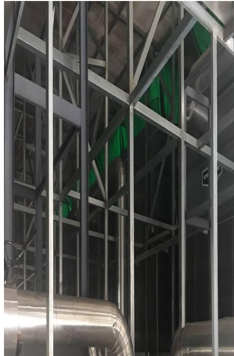
冷却塔风口收集罩
