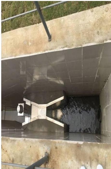
污水处理站出口
