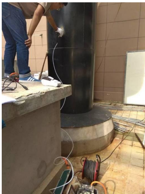
天然气锅炉排口
