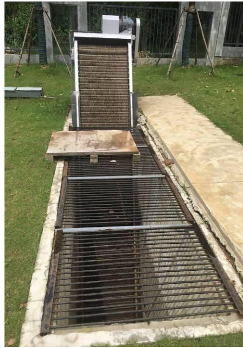
污水处理站进口
